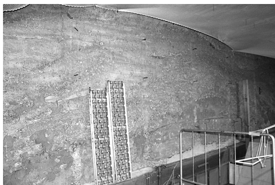
図 39 内壁面から出るボルト痕
